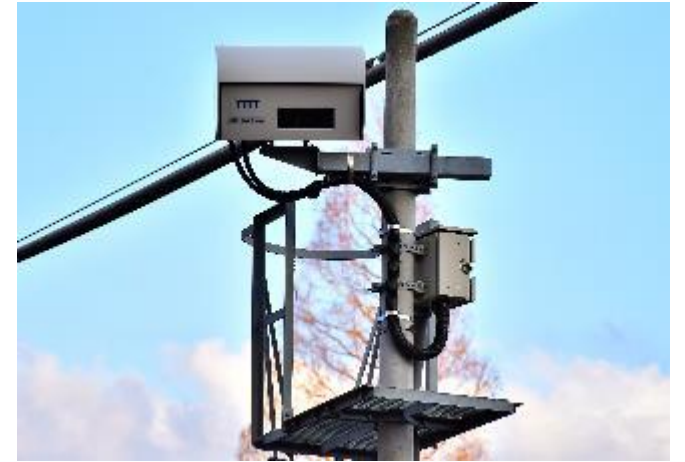
踏切障害物検知装置
