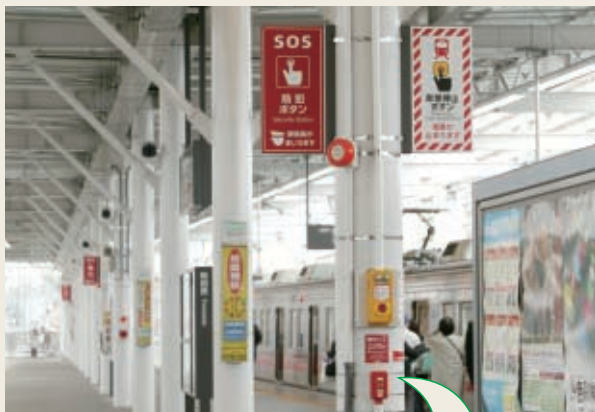
駅構内に設置された防犯ボタン
