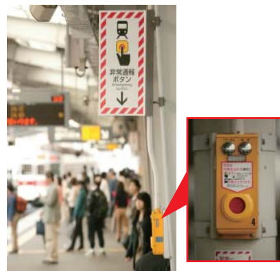
ホームに設置した非常通報ボタン（あざみ野駅）
