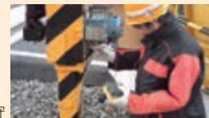
電気設備の保守
