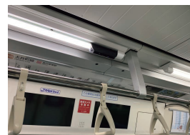
LED蛍光灯一体型 防犯カメラ アイオーチューブ IoTube
